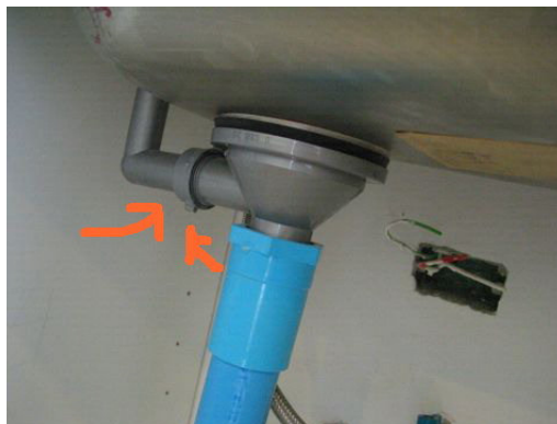
รูปภาพที่ 14 รอยต่างๆของท่อเป็นจุดที่น้ำมักจะรั่วจกบริเวณนี้ถ้าไม่มีการตรวจสอบจะพบภายหลังเมื่อเราเข้าไปอยู่แล้ว
