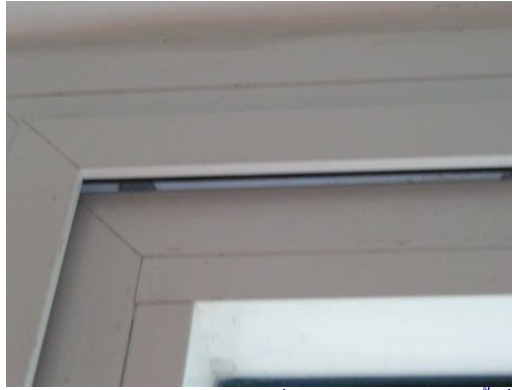
รูปภาพที่ 9 ลักษณะของช่องเปิดที่มีช่องว่างระหว่างบานเปิดกับวงกบซึ่งอาจเกิดจากการติดตั้งที่ไม่ถูกต้องควรจะต้องดำเนินการแก้ไข
