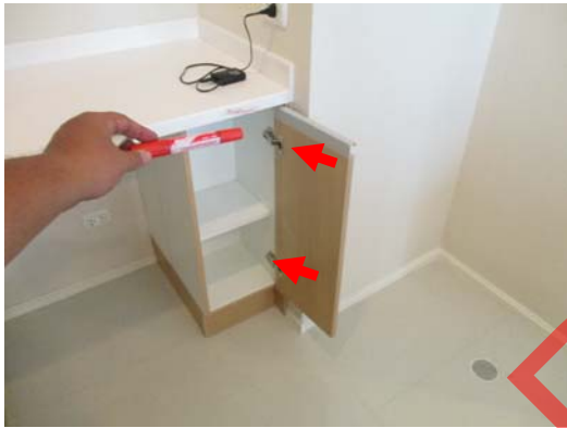
Pic:21 คริ้ว นี้อตบานพับติดเอียงทุกจุด ควรแก้ไขติดนี้อตบานพับใหม่ทุกจุด
