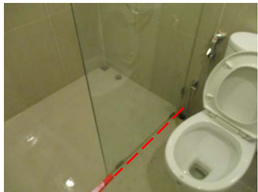
Pic:36 ห้องน้ำรวม ซีลโคนข้างกระจกไม่เรียบ ควรเก็บ ซีลโคนใหม่ทั้งแนว
