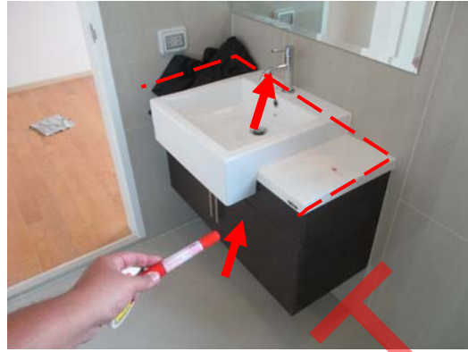
Pic:8 ห้องน้ำห้องนอนใหญ่ บานตู้ปิดไม่สนิท ควรแก้ไข ปรับบานใหม่ และซิลิโคนรอบอ่าง ไม่เรียบ และคราบรอบ ควรเก็บซิลิโคนทำความสะอาดให้เรียบร้อย และก๊อคน้ำไม่แน่น ควรติดให้แน่น
