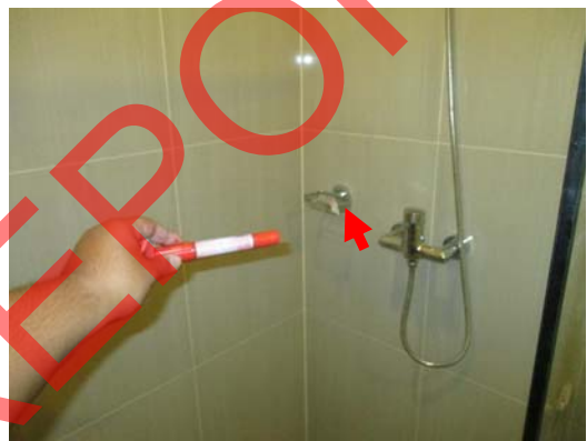
Pic:40 ห้องน้ำรวม ที่วางสบู่ไม่แน่น ควรติดให้แน่น
