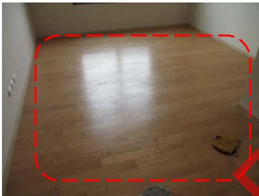
Pic:9 ห้องนอนใหญ่ พื้นไม้เอ็นจิเนียร์ ไม่ได้ระดับทั้งห้อง ควรปรับระดับพื้นใหม่ทั้งห้อง ปูพื้นไม้เอ็นจิเนียร์ให้เรียบร้อย
