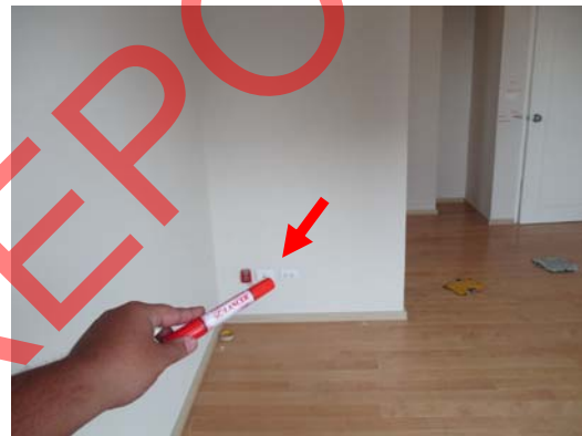
Pic:16 ห้องนอนใหญ่ ปลั๊กไฟตามภาพ ติดตั้งเอียง ควรติดตั้งให้ตรง
