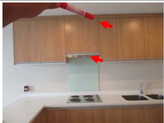
Pic:24 คริ้ว บานตู้ตามภาพ ปิดไม่เสมอกัน ควรปรับบานใหม่ และ พัดลมดูดควัน เป็นสนิม ควรทำความสะอาดให้เรียบร้อย
