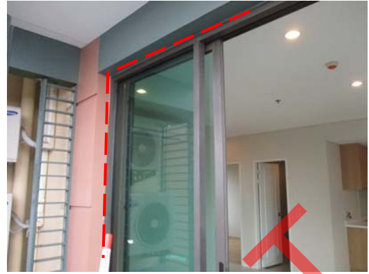
Pic:14 รับแขก-ระเบียง วงกบและกรอบรอบ ซิลิโคนไม่เรียบรอบ ควรเก็บซิลิโคนรอบวงกบ ทำความสะอาด
