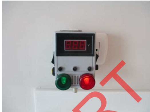
Pic:2 ปลั๊กไฟ ทดสอบแล้ว มีการเดินสายไฟ และสาย กราวนด์ไว้ให้เรียบร้อยทุกปลั๊กไฟ
