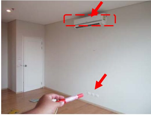
Pic:13 ห้องนอนใหญ่ ปลั๊กไฟตามภาพ และแอร์ ติดตั้งเอียง ควรติดตั้งให้ตรง และซิลิโคนรอบแอร์ ไม่เรียบ ควรเก็บซิลิโคนรอบแอร์
