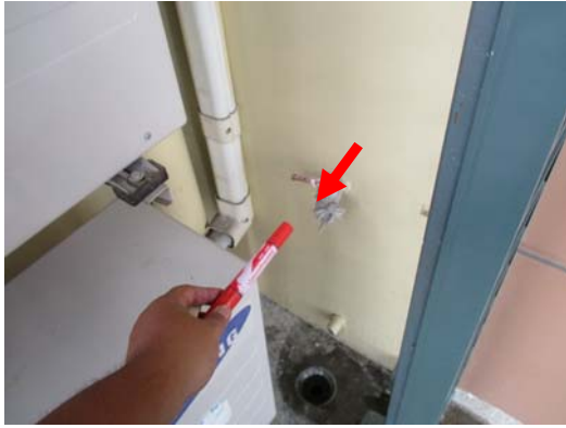
Pic:19 รับแขก-ระเบียง ก๊อกน้ำติดไม่แน่น ควรติดให้แน่น ทำความสะอาดให้เรียบร้อย
