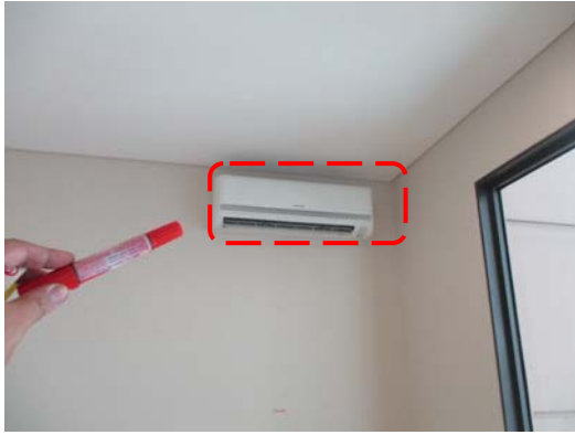
Pic:25 ห้องนอน 2 ซิลิโคนรอบแอร์ไม่เรียบและคราบรอบ ควรเก็บซิลิโคนให้เรียบ ทำความสะอาดให้เรียบร้อย
