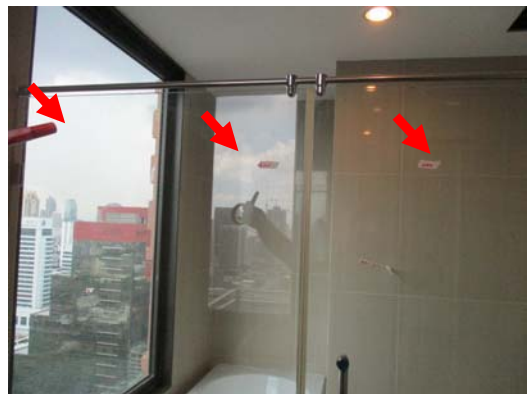
Pic:18 ห้องน้ำห้องนอนใหญ่ บานกระจาก มีรอย ควรทำความสะอาด ถ้าไม่หาย ควรเปลี่ยน
