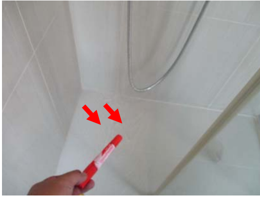
Pic:19 ห้องน้ำห้องนอนใหญ่ กระเบื้องบิ่น 2 แผ่น ควรเปลี่ยน (เทียบสีให้เหมือนก่อนเปลี่ยน)
