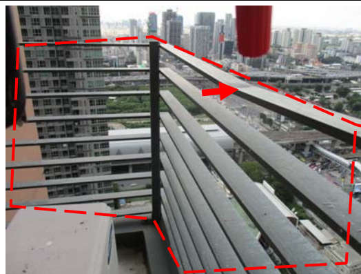
Pic:12 ห้องน้ำห้องนอนใหญ่ เหล็กกระแนง แอ่น บวมควร แก้ไข และเลอะคราบทั่ว ควรทำความสะอาดใหม่รอบ
