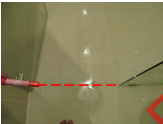
Pic:39 ห้องน้ำรวม ขอบกระเบื้องพื้น คมทั้งแนว ควรลบคม ขอบกระเบื้อง
