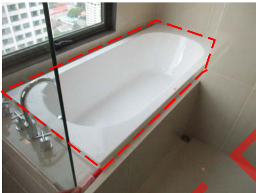
Pic:21 ห้องน้ำห้องนอนใหญ่ ซิลิโคนรอบอ่างอาบน้ำไม่เรียบ เก่า ควรเก็บซิลิโคนใหม่รอบอ่าง
