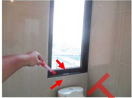
Pic:14 ห้องน้ำห้องนอนใหญ่ มือจับบานประตูไม่แน่น ควรติดให้แน่น และ ปิดฝืด ปิดชนกรอบ ควรแก้ไขปรับตั้งบานใหม่ และกระเบื้องป็น 1 แผ่น ควรเปลี่ยน (เทียบสีให้เหมือนก่อนเปลี่ยน)
