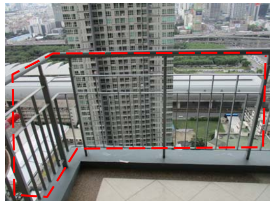
Pic:12 รับแขก-ระเบียง เหล็ก สีไม่เรียบ เหล็กและคราบสนิม ทั้งแนว ควรขัด เก็บสีเหล็กใหม่ทั้งแนว
