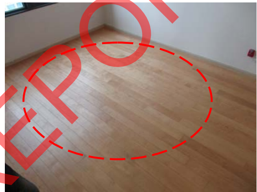
Pic:22 ห้องนอน 2 พื้นไม้เอ็นจิเนียร์ ไม่ได้ระดับทั้งห้อง ไม้บวมทั่ว ควรปรับระดับพื้นใหม่ทั้งห้อง ปูพื้นไม้เอ็นจิเนียร์ ให้เรียบร้อย
