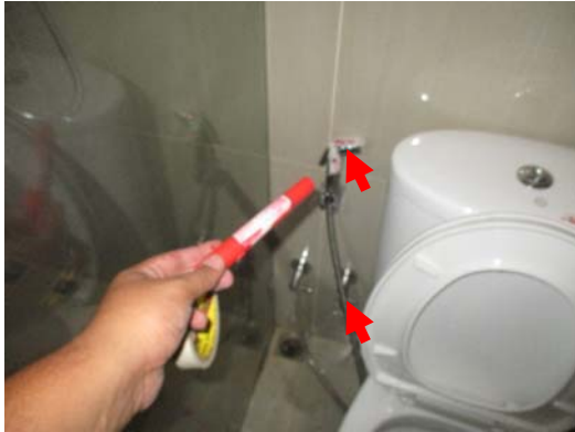
Pic:37 ห้องน้ำรวม ที่หัวสายฉีด และเลอะคราบ ควรแก้ไข เปลี่ยน และฝาล้างไม่แนบ ควรติดให้แนบผนัง
