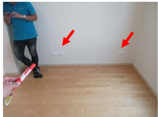
Pic:24 ห้องนอน 2 ปลั๊กไฟตามภาพ ติดตั้งเอียง ควรติดตั้งให้ตรง
