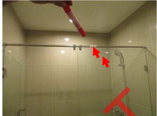
Pic:38 ห้องน้ำรวม เหล็กดำ กระจก แอน ตามภาพ ควรแก้ไข
