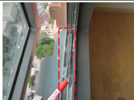
Pic:18 ห้องนอนใหญ่ ซิลิโคนในรางรอบวงกบหน้าต่างไม่เรียบรอบ ควรเก็บซิลิโคนใหม่ และขอบยางหลุด ควรติดขอบยางใหม่
