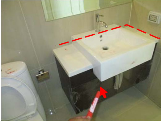
Pic:31 ห้องน้ำรวม มีน้ำรั่วใต้อ่างล้างหน้า ควรแก้ไขระบบท่อ และซีลโคนรอบอ่างไม่เรียบ ควรเก็บซีลโคนรอบอ่าง
