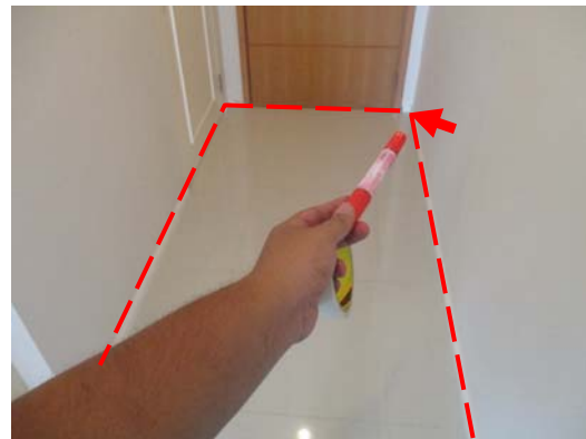
Pic:18 ทางเดิน บัวพื้นสีต่างรอบ ซิลิโคนไม่เรียบ ควรทาสีบัวพื้น เก็บซิลิโคนใหม่รอบ และมูมบัวตามลูกศรมีร่องห่าง ไม่ติดวงกบ ควรแก้ไข
