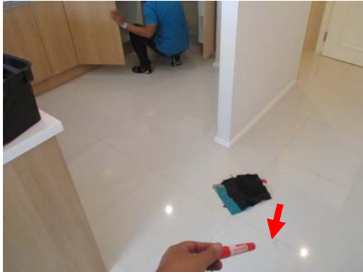
Pic:19 ทางเดิน กระเบื้องพื้นเป็นรอย 1 แผ่น ควร ทำความสะอาด ถ้าไม่หาย ควรเปลี่ยน (เทียบสีให้เหมือนก่อนเปลี่ยน)
