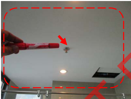
Pic:15 ห้องน้ำห้องนอนใหญ่ ขอบฝ้าแตกรอบห้อง ฝ้าไม่เรียบ สีต่างรอบ ควรไปว ัดให้เรียบ ทาสีใหม่ทั้งห้อง และสปริงเกอร์ ไม่แนบฝ้า ควรติดให้แนบฝ้า
