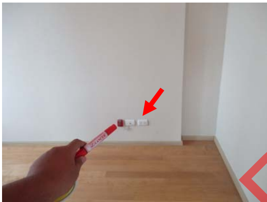
Pic:21 ห้องนอน 2 ปลั๊กไฟตามภาพ ติดตั้งเอียง ควรติดตั้งให้ตรง
