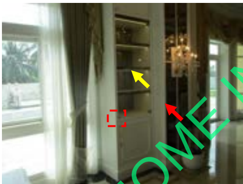
Pic:15 บิวท์เลอะคราบ ควรทำความสะอาด และตัวหนีบ กระจกเป็นสนิม ควรขัดทำความสะอาด และกระจกเป็นรอย ควรทำความสะอาดถ้าไม่หายควรเปลี่ยนใหม่
