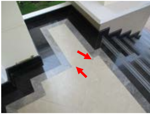
Pic:13 กระเบื้องแตก 2 แผ่น ควรเปลี่ยน (เทียบสีให้เหมือนก่อนเปลี่ยน)
