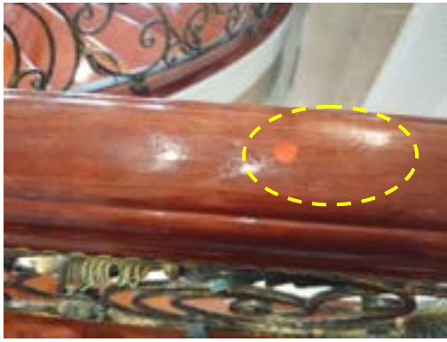
Pic:13 ราวบันไดเป็นรอยขีดข่วน ควรเก็บสีใหม่ให้เรียบร้อย
