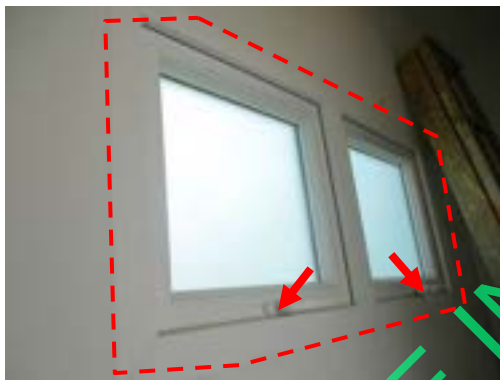
Pic:9 ซิลิโคนขอบเฟรมไม่เรียบ เลอะคราบ ควรเก็บซิลิโคนใหม่ รอบ และมีจ๊อบบานไม่แน่น เลอะ ควรติดตั้งใหม่ แล้วทำความสะอาด
