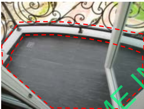
Pic:39 หอมนอน 2 ยาน้ำมันเลอะคราบ ควรทำความสะอาดใหม่ และขอบปูน เลอะคราบ ควรเก็บสีใหม่
