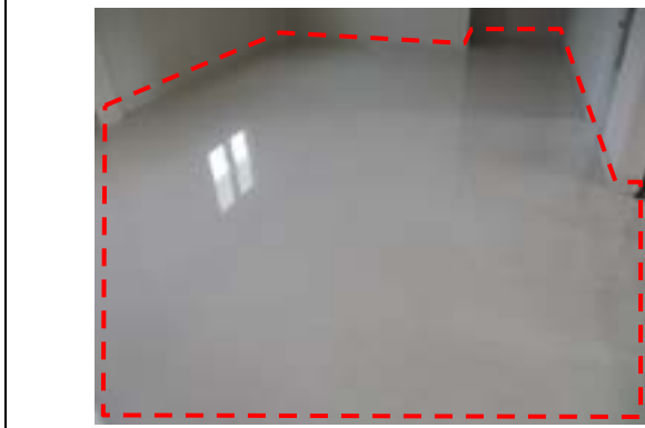
Pic:13 พื้น และบัวเลอะคราบ และยาแนวไม่เรียบ เลอะคราบทั่ว ควรเก็บยาแนวใหม่ และทำความสะอาดใหม่ทั้งหมด
