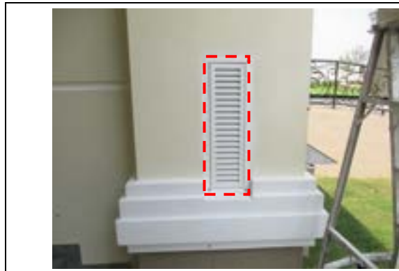
Pic:31 ซิลิโคนขอบวงกบลูมิเนียมไม่เรียบ แตก ควรเก็บซิลิโคนขอบใหม่ และมูมรอยต่อวงกบห่าง ควรเก็บซิลิโคนรอยต่อให้เรียบร้อย
