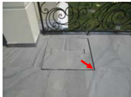
Pic:78 กระเบื้องบิ่น 1 แผ่น ควรเปลี่ยนใหม่ (เทียบสีให้ เหมือนก่อนเปลี่ยน)
