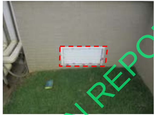
Pic:14 ซิลิโคนขอบเฟรมไม่เรียบ ควรเก็บซิลิโคนใหม่รอบ
