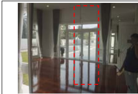
Pic:13 กระจกเป็นรอย บิ่น ควรเช็ด ทำความสะอาดให้เรียบร้อย หากไม่หายควรเปลี่ยนใหม่
