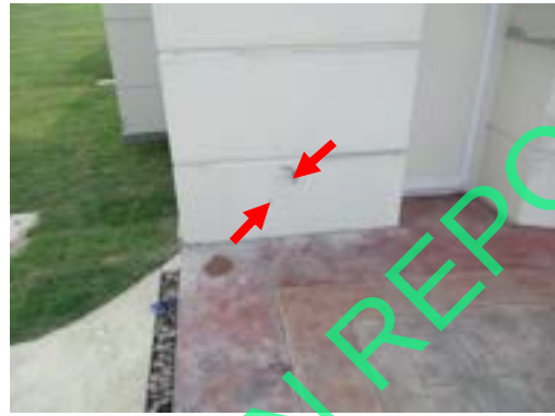
Pic:44 ผนังมีรอยร้าว ควรโป้ว ชัด เก็บสีใหม่ และก๊อกน้ำเลอะสี ควรทำความสะอาดใหม่
