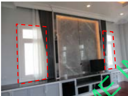
Pic:27 ห้องนอน 2 เฟรมโลหะคราบ ควรทำความสะอาดใหม่ และชิลีคอนรอยต่อเฟรมแตก ควรเก็บชิลีคอนใหม่รอบ
