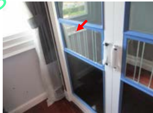
Pic:18 แสดงตัวห้องนอน 2 กระจกเป็นรอย ควรเปลี่ยนใหม่
