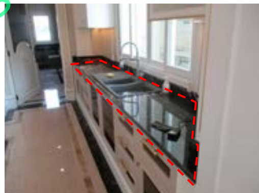
Pic:30 เคาน์เตอร์เป็นรอยทั่ว ควรขัดทำความสะอาด
