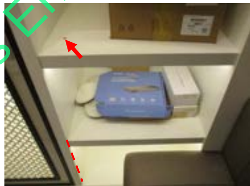
Pic:12 ขอบบิวท์ ไม่เรียบ ควรขัด เก็บสีใหม่ และบิวท์เลอะคราบสนิม ควรทำความสะอาดใหม่
