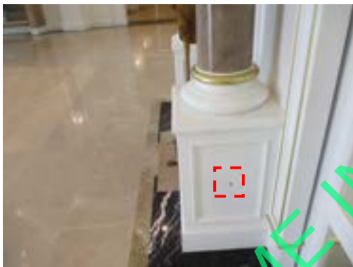
Pic:51 โถงทางเข้า ผนังเลอะคราบ ควรทำความสะอาดใหม่
