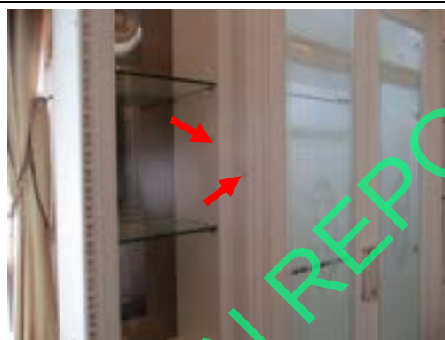
Pic:26 บิวท์แตก ควรโป้ว ชัดเก็บสีใหม่ และนอตยึดบิวท์จม ควรติดตั้งใหม่
