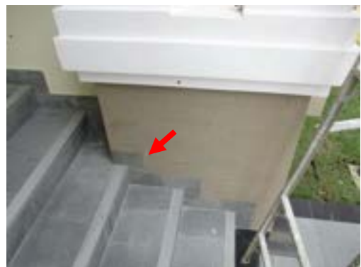
Pic:30 อิฐประดับมีรอยซ่อม ควรเปลี่ยนใหม่
