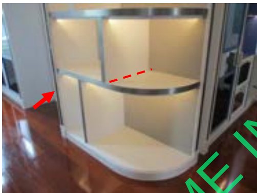
Pic:15 แสดงตัวห้องนอน 2 ซิลิโคนรอยต่อ แตก ควรเก็บ ซิลิโคนใหม่ และบิวท์ไม่เรียบ ควรขัด เก็บสีใหม่
