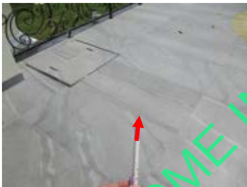
Pic:75 กระเบื้อง กระเด็ด 1 แผ่น ควรเก็บยาแนวใหม่ (ถ้าไม่หาย ควรปูกระเบื้องใหม่)
