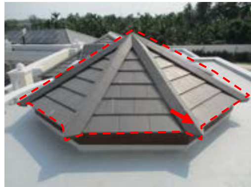
Pic:42 แผ่นหลังคาเลอะสีทั่ว ควรทำความสะอาดใหม่ทั้งหมด และแผ่นครอบสันหลังคาไม่แน่น ควรติดตั้งใหม่
