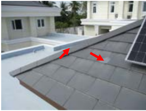
Pic:13 แผ่นหลังคามีรอยซ่อม ควรเปลี่ยนใหม่ และขอบแผ่นครอบสันหลังคาบิน ควรโป้วแต่งสีใหม่ (เทียบสีก่อนแต่งสี)
