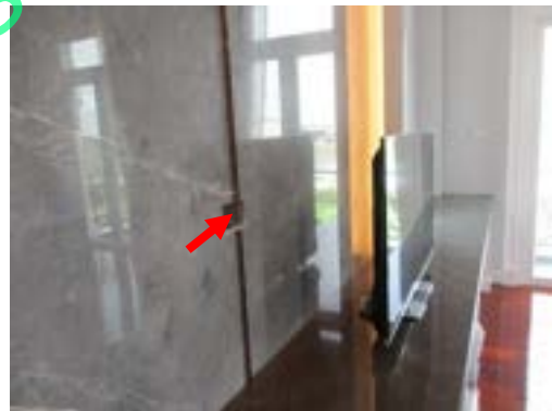
Pic:30 ห้องนอน 2 บล็อกไฟยังไม่ได้ติดตั้ง ควรติดตั้งให้เรียบร้อย
