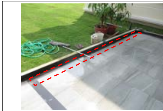
Pic:7 พื้นมีน้ำขังตามภาพ ควรปรับ slope ใหม่ เพื่อให้ น้ำไหลได้สะดวกขึ้น
