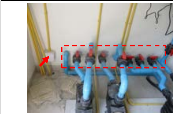
Pic:7 บล็อกไฟเอียง ควรติดตั้งใหม่ และผนังรอบท่อไม่เรียบ ควรโป้ว ชัด เก็บสีใหม่
