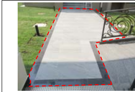
Pic:25 พื้นเลอะคราบ กับยาแนวพื้นไม่เรียบ เลอะคราบ ควรเก็บยาแนวใหม่ แล้วทำความสะอาดใหม่
