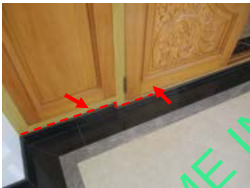
Pic:15 วงกบ กับบานประตูมีรอยเจาะ ควรโป้ว ชัดแต่งสีใหม่ และหลังบัวแตก มีร่อง ควรเก็บซิลิโคนใหม่
