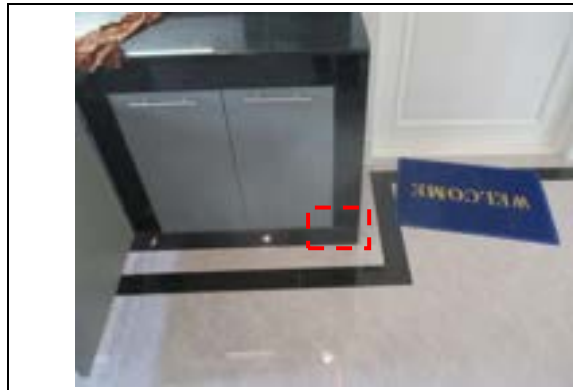
Pic:25 ยานวไม่เต็มร่อง ควรเก็บยานวใหม่
