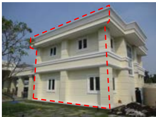
Pic:13 ผนังไม่เรียบ สีย้อย สีต่าง กับเจาะร่องผนังไม่เรียบ สีต่าง ครัวโป๊ว ชัด เก็บสีใหม่ทั้งหมด และบัวปูนไม่เรียบ รอยต่อแตกทั่ว ครัวโป๊ว ชัด เก็บสีใหม่
