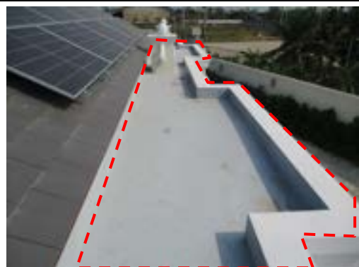
Pic:18 ขอบปูนมีรอยร้าว ไม่เรียบ สีต่าง ควรโป้ว ชัด เก็บสีใหม่ และพื้นมีรอยร้าว เลอะคราบทั่ว ควรกรีดซ่อมรอยร้าวใหม่ทุกจุด แล้วทำความสะอาดใหม่
