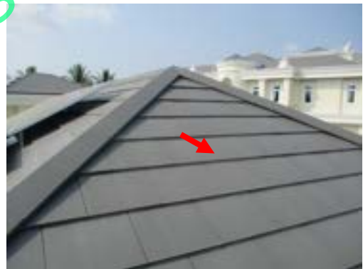
Pic:24 แผ่นหลังคาแตก ร้าว ควรเปลี่ยนใหม่
