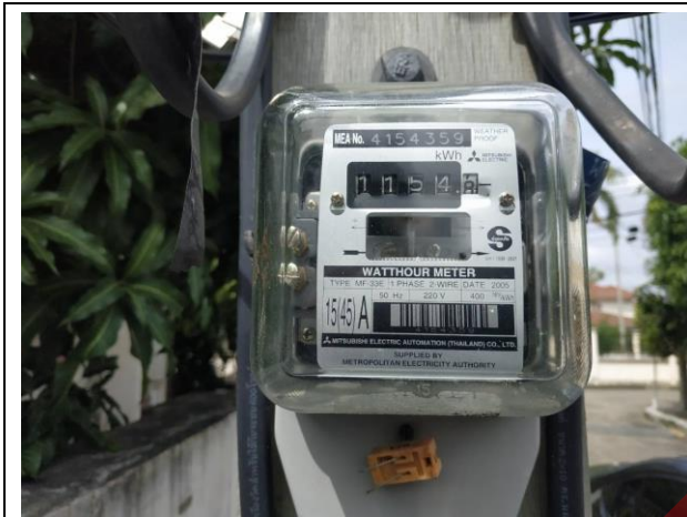
Pic:1 สภาพมิเตอร์ไฟ ขนาด 15/45A
