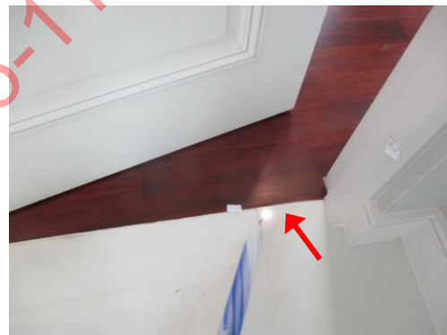
Pic:24 ห้องนอน 4 ขอบกระเบื้องและพื้นไม้ไม่เสมอกัน ควรแก้ไข
