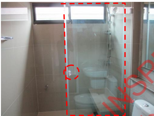
Pic:27 ห้องน้ำนอน 2 บานเลื่อนฝืด และมีมือจับเป็นรอยสนิม ควรปรับบาน และทำความสะอาดมือจับ
