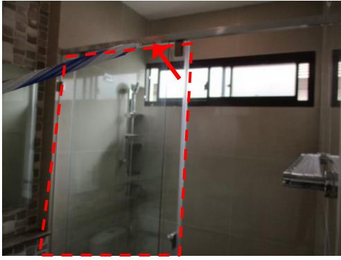
Pic:43 ห้องน้ำนอน 3 ซิลิโคนขอบบานไม่เรียบร้อย และบานเลื่อนฝืด ควรแก้ไข
