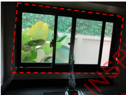
Pic:45 เตรียมอาหาร บานเลื่อนฝ้า และกรอบมีรอยทั่ว ควรแก้ไขติดตั้งใหม่
