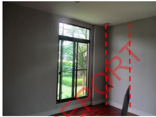
Pic:26 ห้องนอน 4 รอยต่อวอลเปเปอร์ไม่แนบทั้งห้อง ควรรีดให้แนบ
