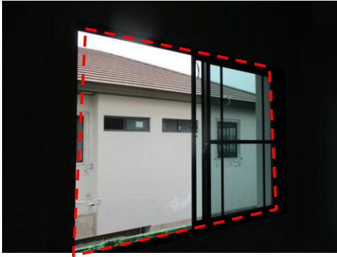
Pic:67 ห้องนอน 2 บานเลื่อนเปิด มีเสียง ควรแก้ไขติดตั้งใหม่ และวอลเปเปอร์ไม่แนบขอบรอบ ควรแก้ไข
