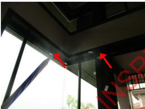
Pic:33 ห้องนอน 1 ขางกรอบกระจกจม และรอยต่ออลูมิเนียมห่าง ควรแก้ไขติดตั้งใหม่
