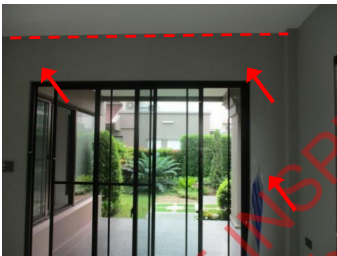
Pic:33 ทานอาหาร วอลเปเปอร์ขาด รอยต่อวอลไม่แนบ และฝ้าไม่เรียบ ควรติดตั้งวอลเปเปอร์ใหม่ และขัดฝ้าให้เรียบ
