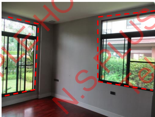
Pic:29 ห้องนอน 4 วอลเปเปอร์รอบกรอบไม่แนบ ควรติดตั้งใหม่
