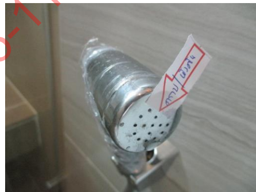
Pic:24 ห้องน้ำนอน 2 หัวที่ฉีดชำระมีคราบ ควรทำความสะอาด
