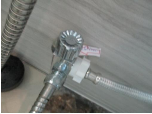
Pic:25 ห้องน้ำนอน 2 วาล์วสายฉีดมีคราบ ฟาลิ่งไม่แนบ ควรแก้ไข
