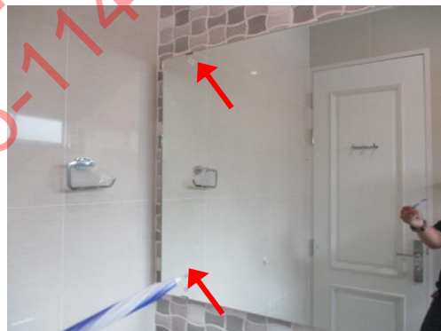
Pic:42 ห้องน้ำนอน 3 กระจกปรอทขาด ควรแก้ไขหรือเปลี่ยนใหม่
