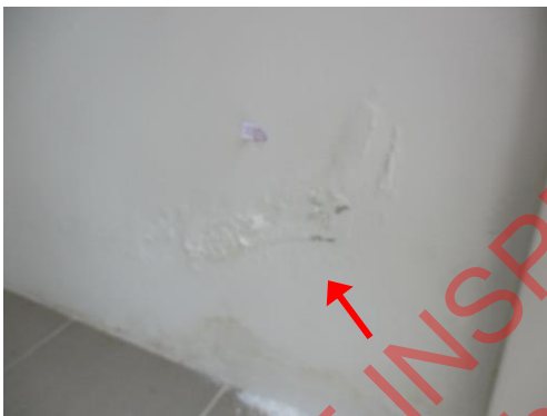
Pic:27 สีดินผนังติดวงกบ พอง มีคราบน้ำรั่ว ควรตรวจสอบและแก้ไข
