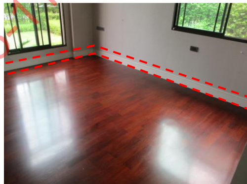
Pic:30 ห้องนอน 4 บั้วรอบห้อง มีคราบ รอยต่อไม่เรียบ ควรโป๊วแต่งรอยต่อ เก็บสีและทำความสะอาดให้เรียบร้อยรอบ
