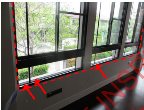
Pic:27 ห้องนอน 1 กรอบหน้าต่างมีรอยทั่ว ควรเก็บสีใหม่ และติดวอลเปเปอร์รอบกรอบให้แนบทุกบาน
