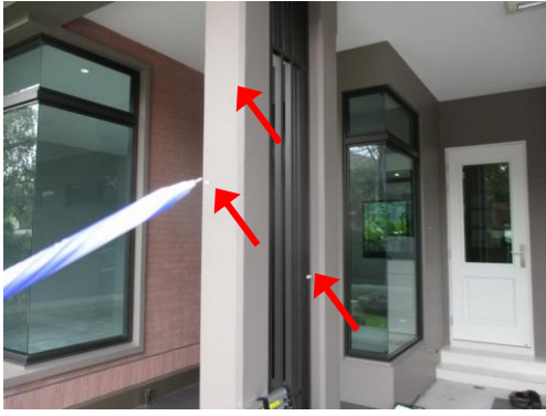
Pic:25 ขอบเสาน้ำบ้านปลิว ไม่ตรง และอลูมิเนียมมีรอยทั่ว ควรแต่งผิวปูน และพ่นสีเก็บอลูมิเนียม
