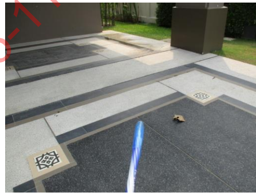
Pic:18 พื้นจอดรถมีคราบทั่ว และบางจุดกระเบื้องบิ่น ควรแก้ไข
