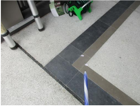
Pic:19 กระเบื้องพื้นที่จอดรถแตก ควรเปลี่ยนใหม่
