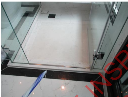
Pic:9 ห้องน้ำนอน 1 คิวสแตนเลสไม่แน่น ควรยึดให้แน่น
