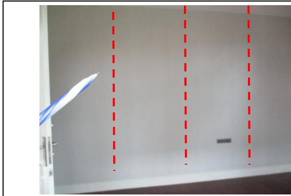
Pic:25 ห้องนอน 4 รอยต่อวอลเปเปอร์ไม่แนบทั้งห้อง ควรรีดให้แนบ
