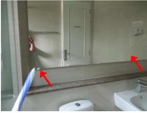
Pic:7 ห้องน้ำนอน 4 ขอบกระจะกบ้น ควรแก้ไขหรือเปลี่ยนใหม่
