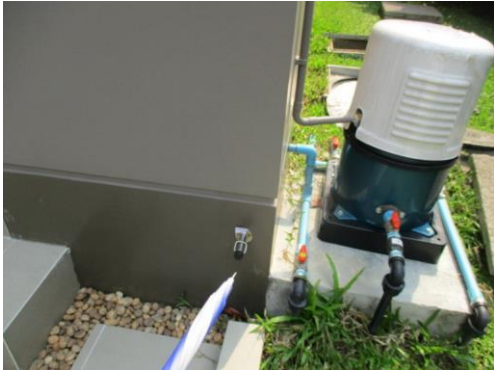
Pic:19 ช่างบ้าน น๊อตยึดตัวกันกระแทกเป็นสนิม ควรเปลี่ยน น๊อตใหม่
