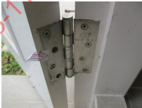
Pic:30 ห้องน้ำแม่บ้าน น็อตชุดบานพับประตูห้องน้ำเป็นสนิม และมีคราบทุกตัว ควรเปลี่ยนน็อต และทำความสะอาดบานพับทุกตัว
