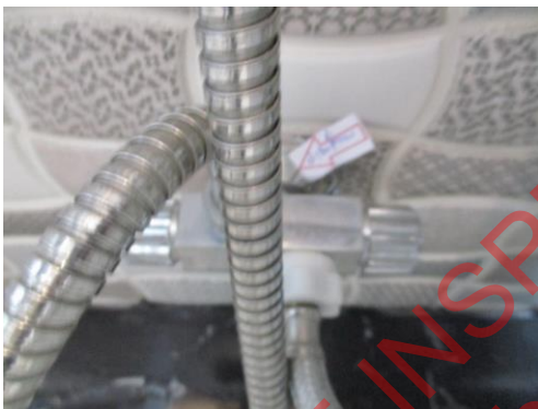
Pic:39 ห้องน้ำนอน 3 ฝาฉิ่งไม่แน่น ควรติดตั้งใหม่
