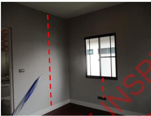
Pic:75 ห้องนอน 3 รอยต่อวอลเปเปอร์ไม่แนบ ควรรีดให้แนบ
