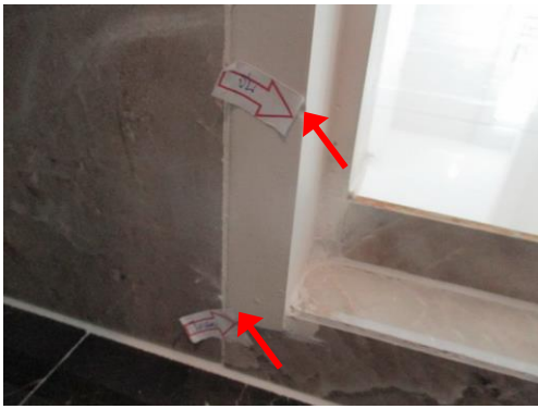
Pic:13 ห้องน้ำรวม วงกบบิ้น และ วงกบกับกระเบื้องไม่เสมอกัน ควรไปวัดวงกบ และติดกระเบื้องให้เสมอมวงกบประตู
