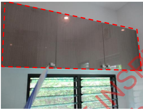
Pic:57 ครั้ว บานตู้ตกทุกบาน ควรวัดแก้ไขปรับบานใหม่
