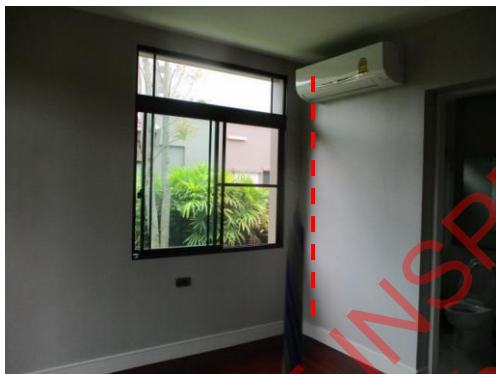
Pic:27 ห้องนอน 4 รอยต่อวอลเปเปอร์ไม่แนบทั้งห้อง ควรรีดให้แนบ
