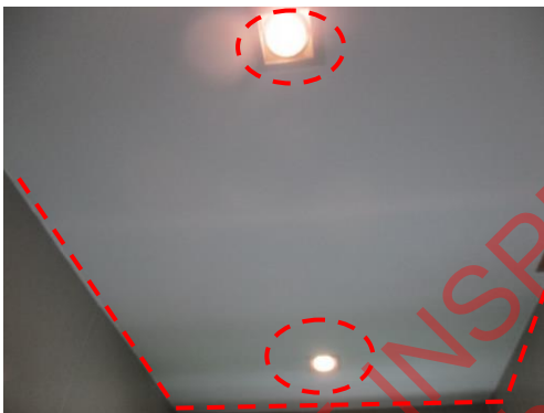
Pic:21 ห้องน้ำนอน 2 ขอบฝ้าและรอบโคมไฟไม่เรียบ ควรแก้ไข
