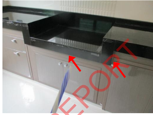
Pic:62 ครั้ว ซิลิโคนรอยต่อไม่เรียบร้อย ควรซิลิโคนให้เรียบร้อย
