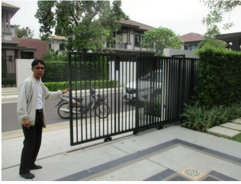
Pic:31 มอเตอร์ประตูเลื่อนไม่เลื่อนปิด ควรตรวจสอบ
