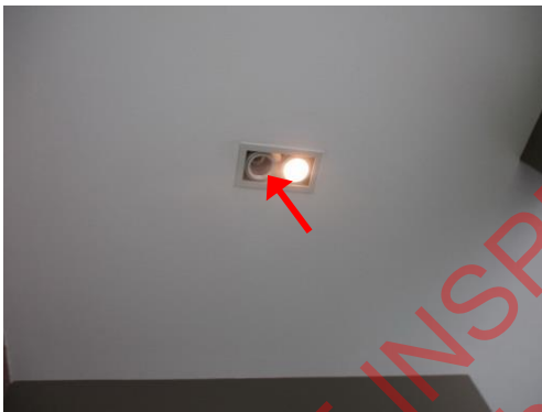
Pic:33 หลอดไฟโถงทางเข้าไม่ครบ ควรใส่ให้ครบ
