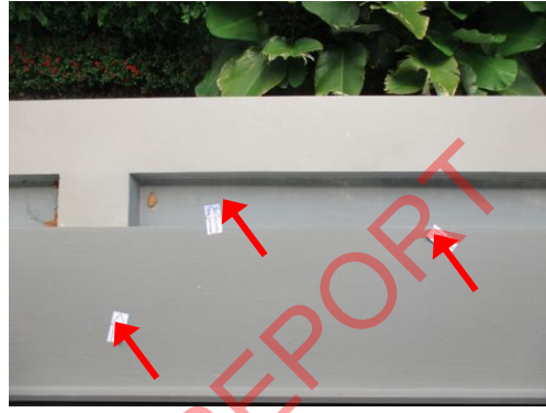
Pic:68 ห้องนอน 2 ขอบพนักกันสาดด้านหลังรั้ว สีต่าง ควรโป้วขัดแต่งผิวเก็บสี และทาสีเก็บให้เรียบร้อย
