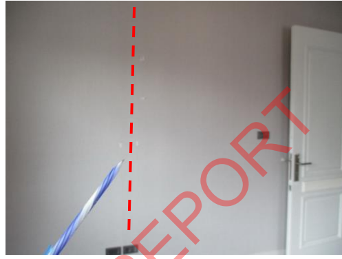
Pic:74 ห้องนอน 3 รอยต่อวอลเปเปอร์ไม่แนบ ควรรีดให้แนบ
