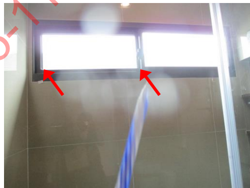
Pic:30 ห้องน้ำนอน 2 อลูมิเนียมเป็นรอย ควรพ่นเก็บสี
