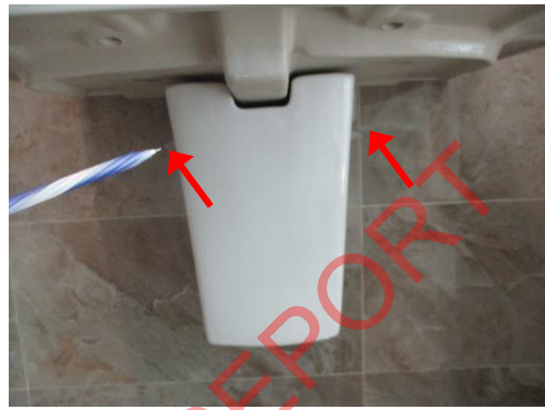
Pic:14 ห้องน้ำรวม ใต้อ่างล้างหน้ามีรูเจาะ 2 รู ควรแก้ไขปิดรู
