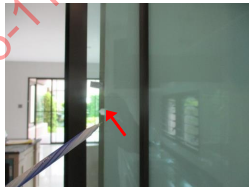
Pic:54 ครีว ขอบผนังด้านในมีคราบ ควรทำความสะอาดให้เรียบร้อย
