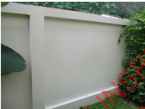
Pic:15 หลังบ้าน กำแพงร้วรอบบ้านร้ว ไม่เรียบสีต่างทั้งหลัง ควรไปวัดแต่งผิวให้เรียบ และเก็บสีใหม่ทั้งหลัง
