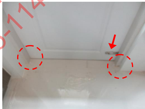
Pic:66 ครั้ว ขาแนวตึนวงกบไม่เรียบร้อย และที่ล๊อคเป็นสนิม ควรขานวใหม่ และทำความสะอาดที่ล๊อคให้เรียบร้อย
