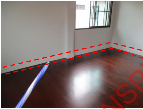
Pic:63 ห้องนอน 2 ขอบบัวรอบห้อง รอยต่อไม่เรียบ สีต่าง ควรแต่งรอยต่อให้เรียบ และเก็บสีรอบห้อง
