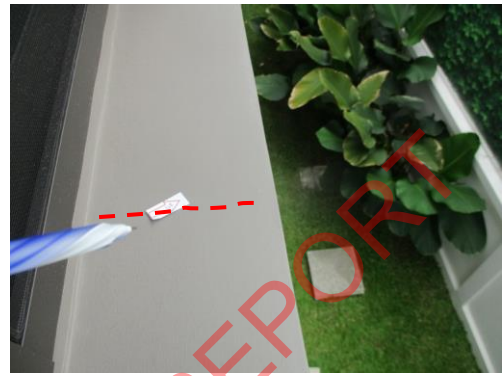
Pic:74 ห้องนอน 3 ขอบปูนด้านหลังนอกหน้าต่างร้าง ควรไปวัดแต่งผิวให้เรียบ และทาสีเก็บให้เรียบร้อย
