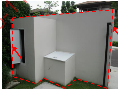
Pic:12 ผนังรั้วสีด่างทั่ว ควรเก็บสีใหม่ และบานตู้ไฟตัว ล็อคปิดไม่ได้ ควรแก้ไขเปลี่ยนใหม่
