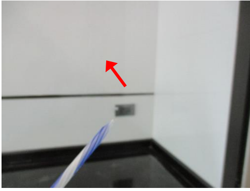
Pic:61 ครั้ว เต้ารับเอียง ควรแก้ไขติดตั้งใหม่
