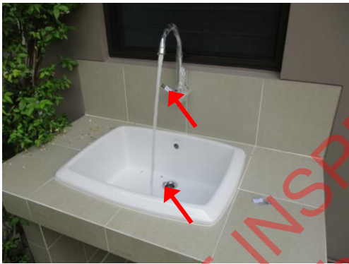
Pic:21 ช่างบ้าน ก๊อกมีคราบ และ ไม่มีสะดืออ่าง ควรแก้ไข
