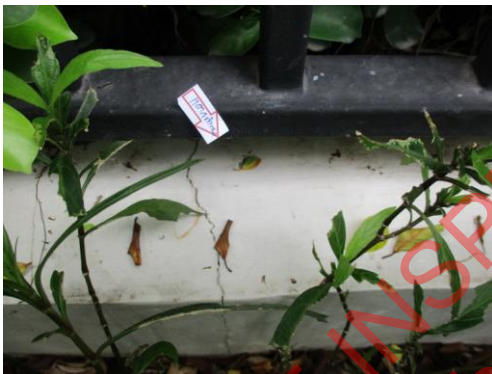
Pic:15 คานาคอดินรับร้วเหล็กข้างบ้านร้าวแตก ทั้งแนว ควรแก้ไข
