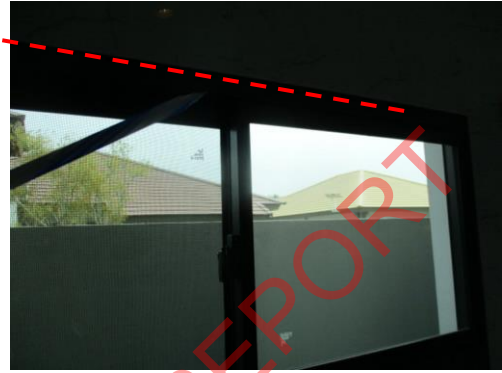
Pic:8 ห้องน้ำนอน 1 ขาแนวขอบเหนือหน้าต่างแตก ควรขยายแนวใหม่ทั้งแนว
