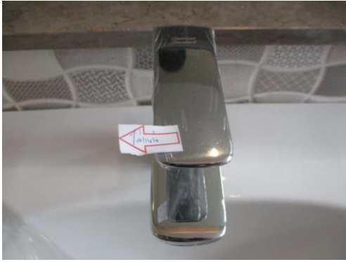
Pic:37 ห้องน้ำนอน 3 ก๊อกอ่างล้างหน้าไม่แน่น ควรยึดให้แน่น
