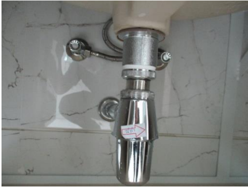
Pic:7 ห้องน้ำนอน 1 ข้อต่อได้อ่างล้างหน้ารั่ว ควรแก้ไข
