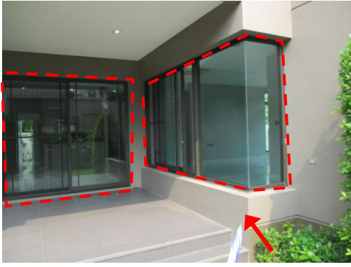
Pic:7 ช้างบ้าน ผนังไม่เรียบสีต่าง ซิลิโคนกรอบหน้าต่างไม่เรียบร้อย ควรแก้ไข
