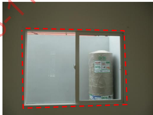
Pic:30 ห้องอเนกประสงค์ บ้านเลื่อนฝืด และเลื่อนมีเสียง ควรแก้ไขปรับบานใหม่
