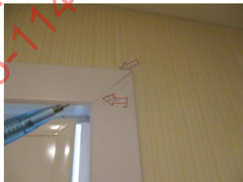
Pic:12 มุมวงกบประตูด้านในไม่เสมอ ควรแก้ไขติดตั้งใหม่
