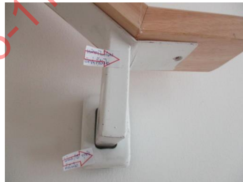
Pic:12 ตัวปิดรอยต่อยึดบันไดหลุด ควรยึดให้แน่นทุกจุด และเหล็กราวบันไดทาสีไม่เรียบร้อยทั้งบันได ควรทาสีใหม่
