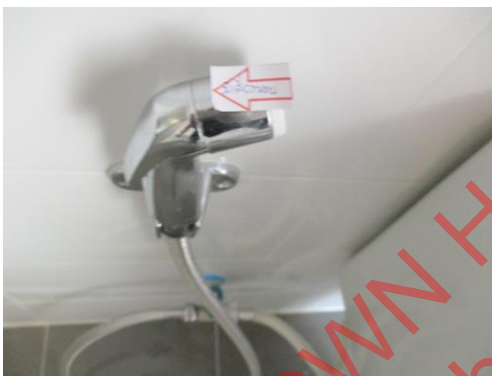
Pic:15 ห้องน้ำรวม สายฉีดชำระเวลาใช้งานมีเสียงหอน ควร ตรวจสอบและแก้ไข หรือเปลี่ยนใหม่
