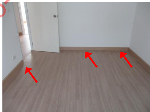
Pic:24 ห้องนอน 2 พื้นลามิเนตยวบขอบรอบ ควรแก้ไขปูพื้นลามิเนตใหม่
