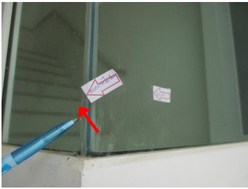
Pic:19 กระจกบิ่น ควรแก้ไขเปลี่ยนกระจกใหม่
