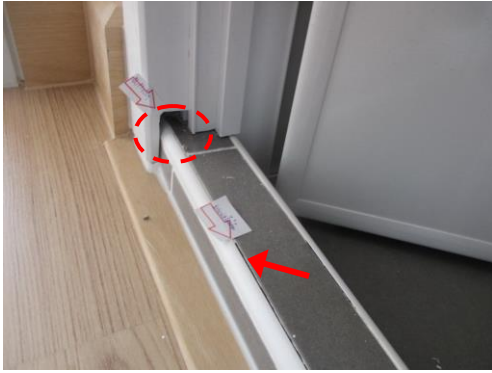
Pic:13 ห้องน้ำรวม วงกบมีรู ควรเปลี่ยนวงกบ และขานแนว กระเบื้องชนิดประตู่ให้เรียบร้อย
