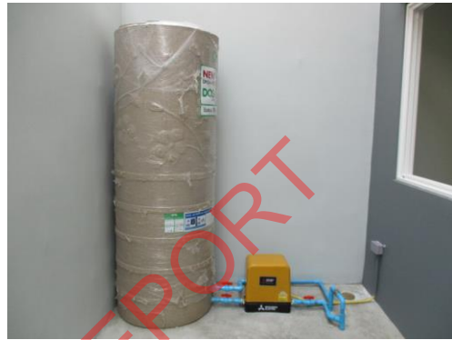
Pic:2 สภาพถังน้ำดี ปิมน้ำ อยู่ในสภาพปกติ
