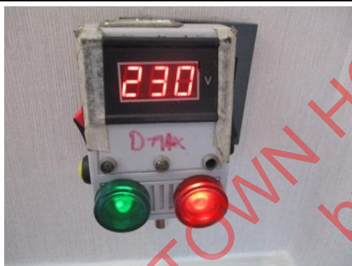
Pic:3 ปลั๊กไฟ ทดสอบแล้ว มีการเดินสายไฟ และสายกราวด์ไว้ให้เรียบร้อยทุกปลั๊กไฟ
