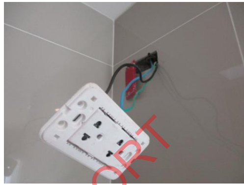
Pic:8 ห้องน้ำห้องนอน 1 Junction Box เครื่องทำน้ำอุ่น ไม่ได้เก็บใส่ Box ควรเก็บให้เรียบร้อย
