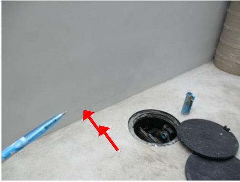
Pic:7 ดินผนังมีคราบชื้น ควรตรวจสอบและทำการแก้ไข และเก็บสีให้เรียบร้อย
