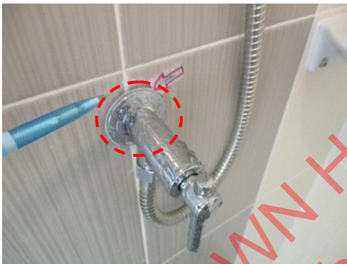
Pic:9 ฝาล้างวาล์วฝักบัวไม่แนบผนัง ควรติดตั้งให้แนบผนัง
