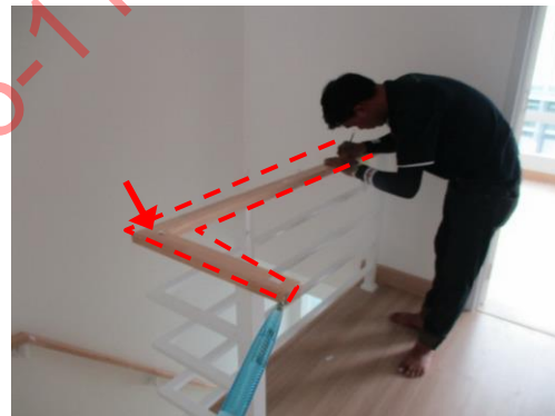
Pic:18 ราวบันไดมีรอยทัว และรอยต่อห่าง ควรขัดผิวให้ เรียบ และเก็บรอยต่อราวบันไดให้เรียบร้อย
