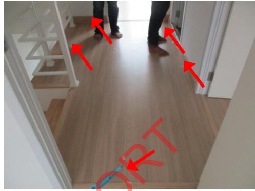
Pic:20 ขอบพื้นลามิเนตรอบโถงชั้น 2 ยุบ ควรแก้ไขปูพื้นลามิเนตใหม่
