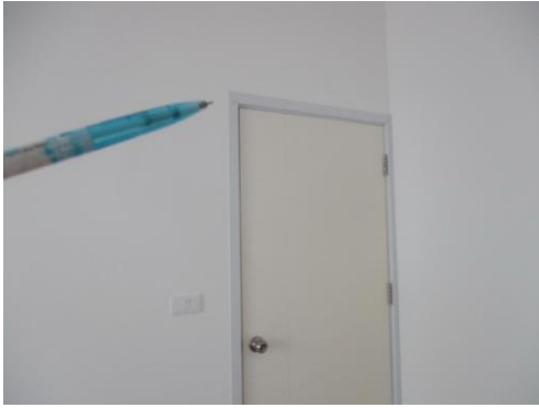
Pic:25 ห้องนอน 2 มุมวงกบประตูไม่เสมอ ควรแก้ไขติดตั้งใหม่
