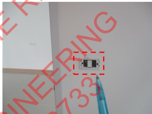
Pic:28 ห้องอเนกประสงค์ สวิตซ์ไฟไม่มีหน้ากาก ควรใส่หน้ากากให้เรียบร้อย
