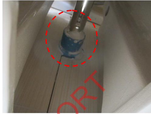
Pic:8 น้ำรั่วใต้อ่าง ควรแก้ไขติดตั้งใหม่
