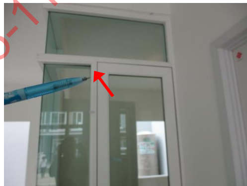
Pic:18 ห้องนอนประสงค์ ขางขอบหน้าต่างบิด ควรแก้ไข เดินข่างใหม่
