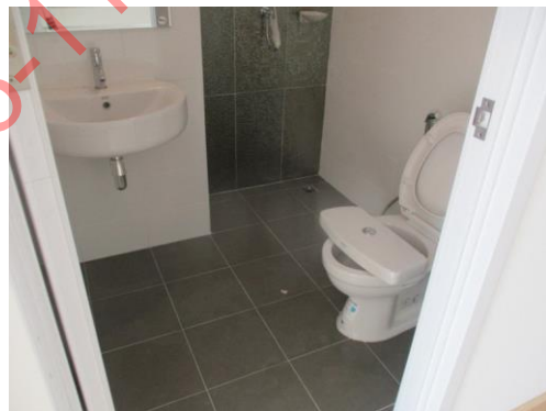
Pic:12 ห้องน้ำรวม ยาแนวพื้นไม่เรียบร้อย ควรยาแนวให้เรียบร้อยทั้งห้อง
