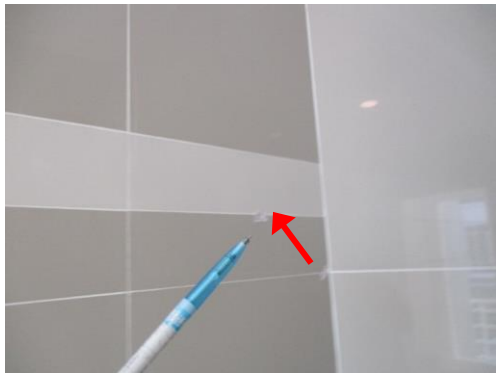
Pic:7 ห้องน้ำห้องนอน 1 กระจกเบื้องผนังส่วนเปียกบิ่น ควรแก้ไข หรือเปลี่ยนกระเบื้องใหม่
