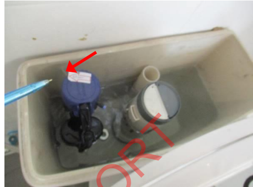
Pic:14 ห้องน้ำรวม หัวจ่ายน้ำเข้าแทงค์ชัก โคลกแตก มีน้ำพุ่ง ออกด้านข้าง ควรตรวจสอบ และแก้ไขหรือเปลี่ยนใหม่
