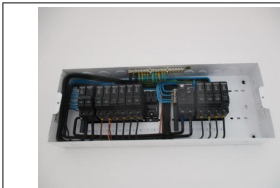
Pic:1 สภาพทั่วไปตู้ไฟฟ้า ขนาดเบรกเกอร์ ขนาดสายไฟ การเข้าสายเรียบร้อย
