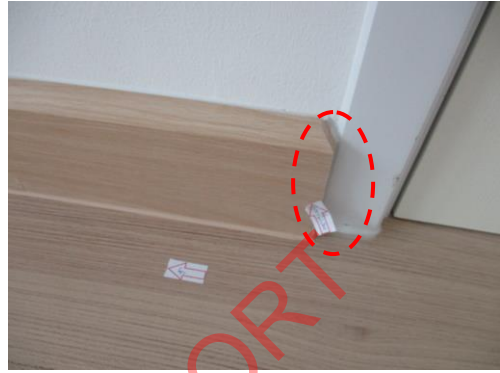
Pic:26 ห้องนอน 2 มุมบัวพื้นข้างวงกบไม่เสมอ ควรติดตั้งมุมบัวใหม่
