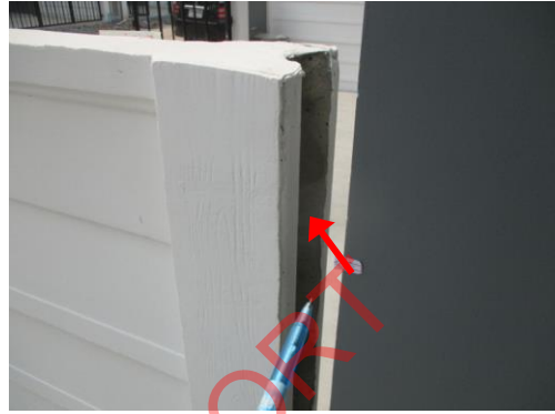
Pic:14 เสาก้ำแพงไม่ได้ทาสีด้านใน ทั้ง 2 ข้าง ควรทาสีให้เรียบร้อย
