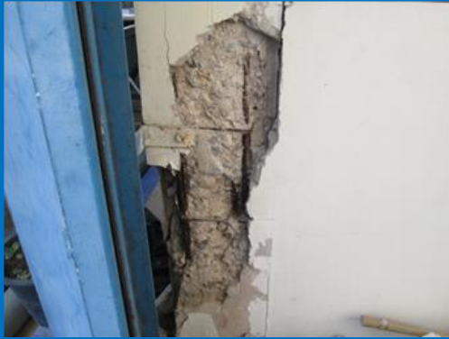
ภาพที่ 1: เหล็กเสริมในโครงสร้างเป็นสนิม
