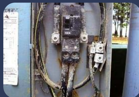
ระบบไฟฟ้า
